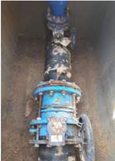
Foto 11. 20240318_Pozo 1° Finca C - Ventosa 80,válvula mariposa 80,carrete desmontaje y válvula corte 250 mm
