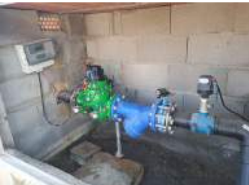
Foto 29. 20240318_M1 54 Detalle. Hidrante compacto DN 80 S900G + otros elementos
