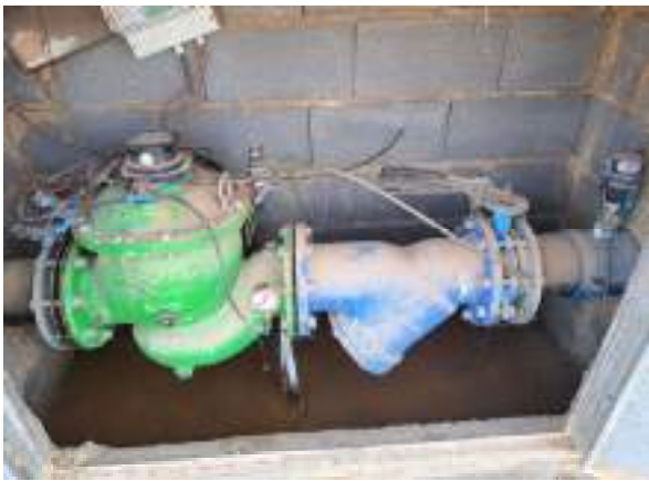
Foto 16. 20240318_G3 Detalle. Hidrante compacto DN 150 S900G + otros elementos
