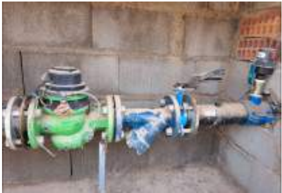
Foto 6. 20240318_C 15 Detalle Hidrante compacto DN 50 S900G + otros elementos
