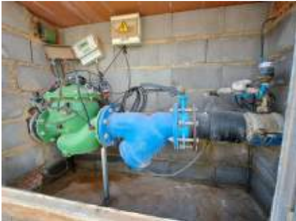
Foto 32. 20240318_M1 62 Detalle. Hidrante compacto DN 150 S900G + otros elementos
