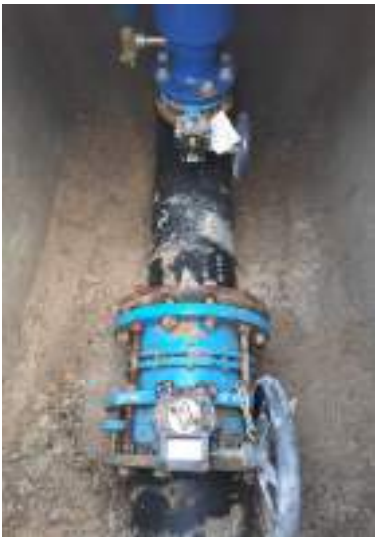
Foto 14. 20240318_Pozo 2° Finca C - Ventosa 80,válvula mariposa 80,carrete desmontaje y válvula corte 250 mm
