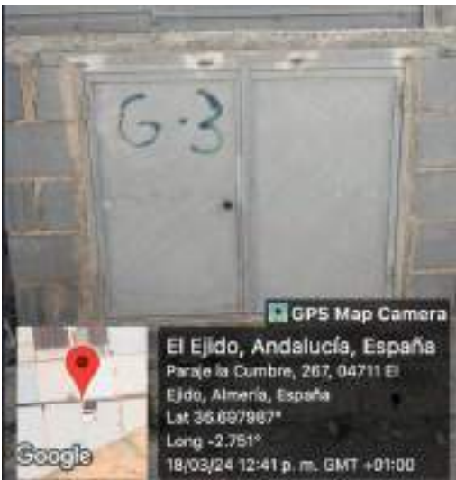
Foto 17. 20240318_G3. Hidrante G3 ubicación
