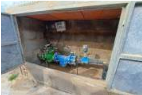
Foto 19. 20240318_H 10 interior. Hidrante compacto DN 50 S900G + otros elementos
