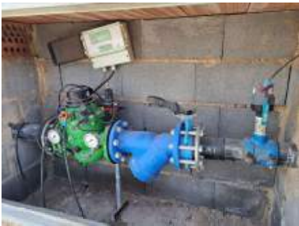
Foto 26. 20240318_M1 1 Detalle. Hidrante compacto DN 80 S900G + otros elementos
