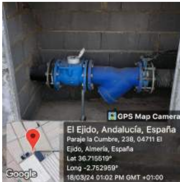
Foto 1. 20240318_A 20 detalle. Hidrante compacto DN 150 S900G + otros elementos
