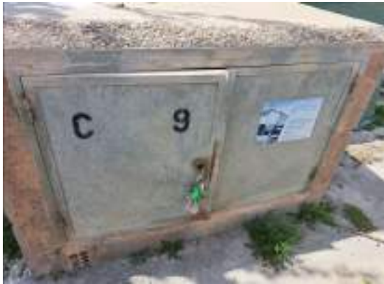
Foto 5. 20240318_C 9. Arqueta hidrante C 9
