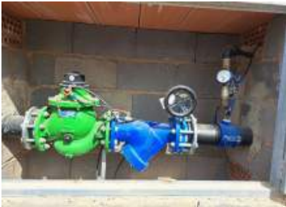
Foto 38. 20240318_P 10 Detalle. Hidrante compacto DN 100 S900G + otros elementos
