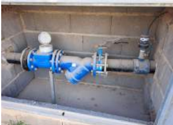
Foto 36. 20240318_M1 71 Detalle. Hidrante compacto DN 100 S900G + otros elementos
