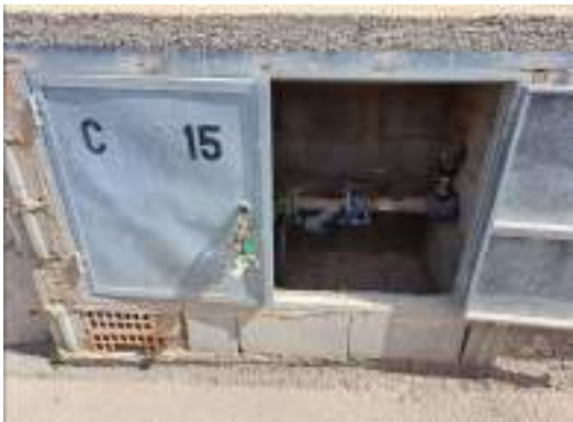
Foto 8. 20240318_C 15. Arqueta hidrante C 15
