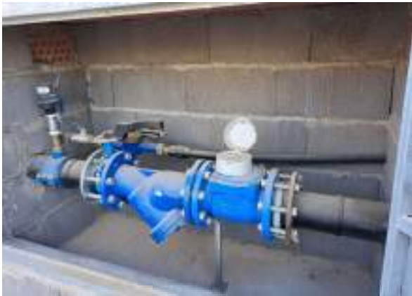
Foto 34. 20240318_M1 63 Detalle. Hidrante compacto DN 100 S900G + otros elementos
