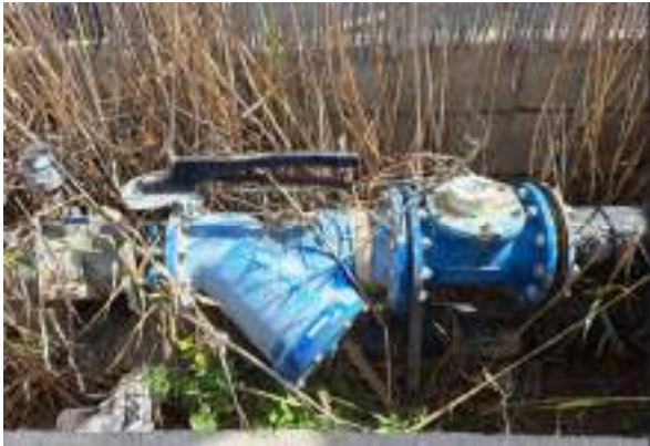
Foto 18. 20240318_H 1 hidrante partido DN 200. Hidrante partido DN 200 + otros elementos
